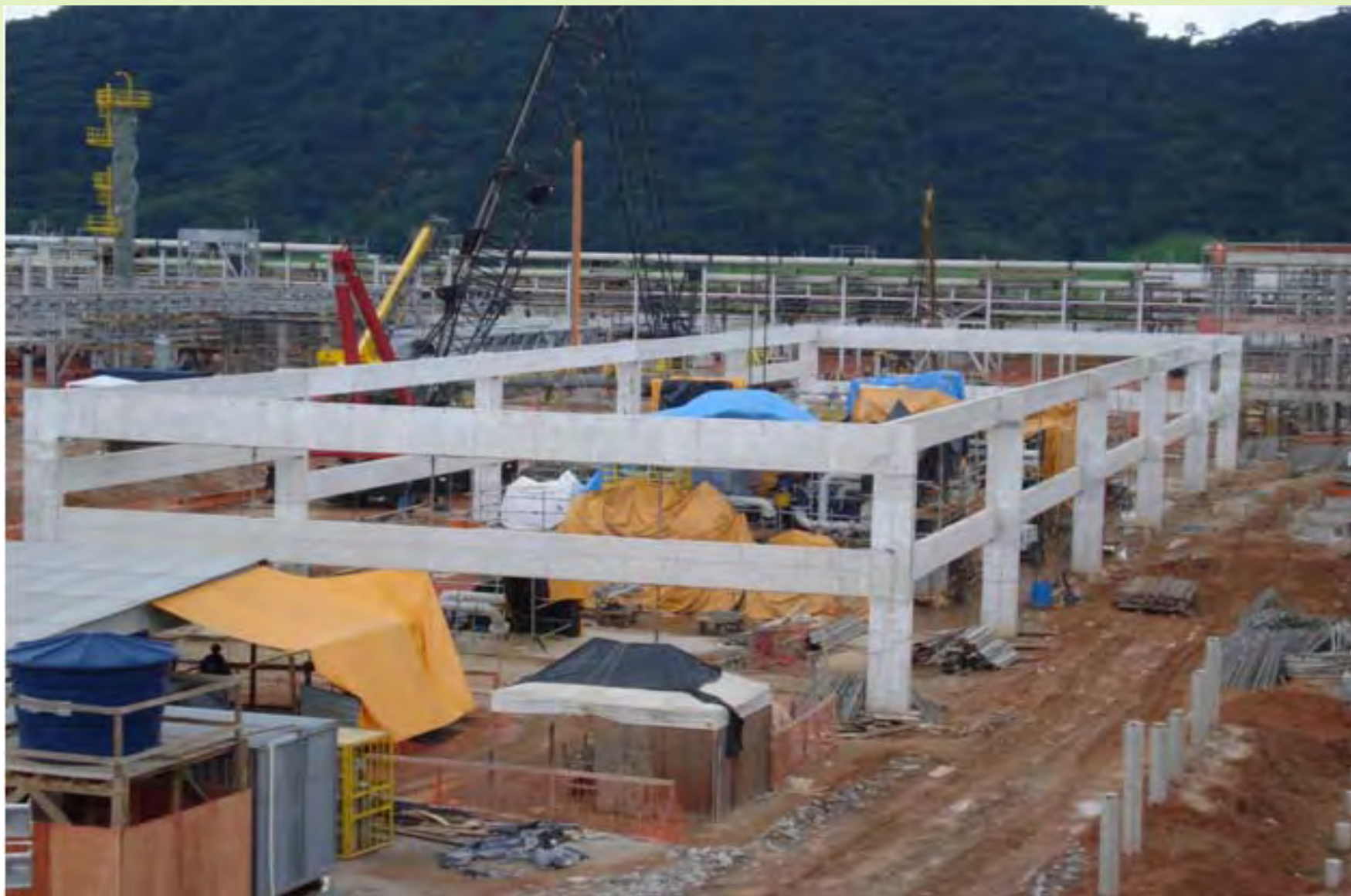
ESTRUTURA – COMPRESSORES DE GÁS PROPANO
