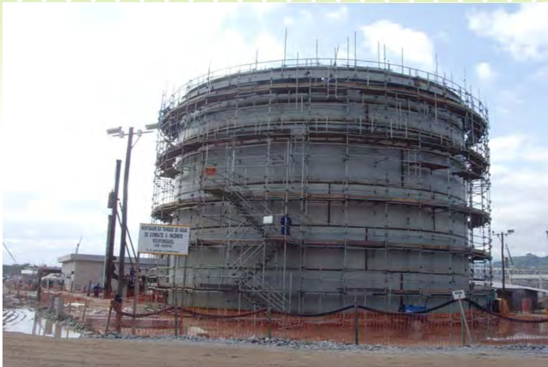
TANQUE DE COMBATE INCÊNDIO
