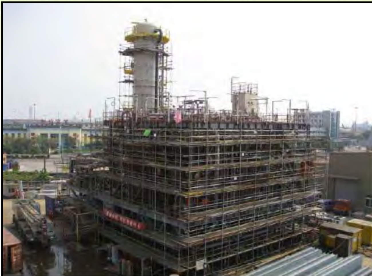
Tratamento de Água de Injeção
